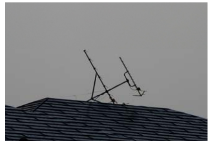
屋根馬型はワイヤーが切れて危険です
