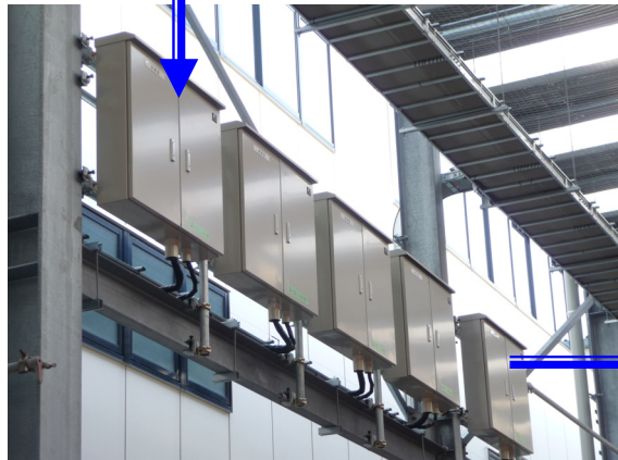
接続箱(直流ケーブルを接続)
