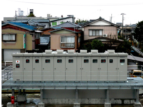
屋外受変電設備(1850KVA)
