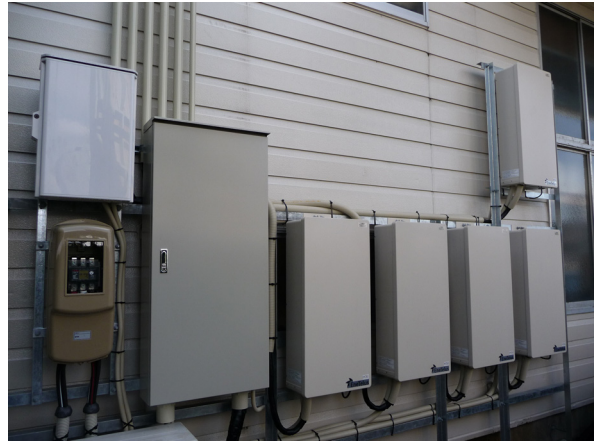
売電用電力メーター、接続箱、パワーコンディショナー
