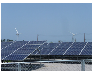
太陽光パネル
