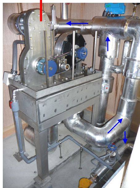
水力発電装置 (吉ヶ平山荘内 発電機室)
