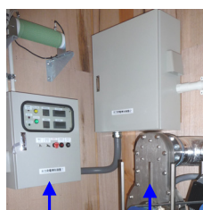
制御盤と水車部
