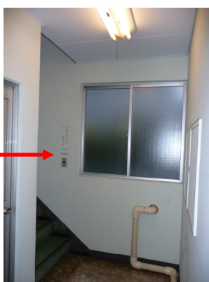
既存階段スイッチ
