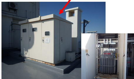
S市消防署屋上キュービクル (更新前平成8年更新)
