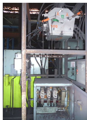
正逆変換用気中開閉器と短絡盤
