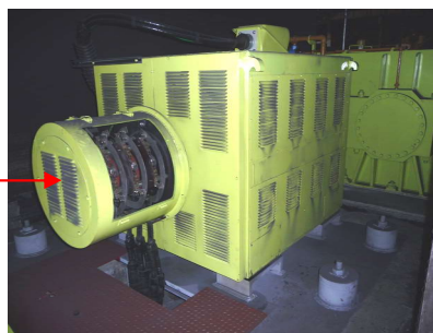
新設高圧モーター (3KV-1000 k w)
