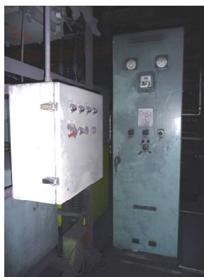
水抵抗制御盤と高圧電磁開閉器盤
