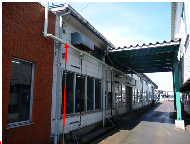
↑ 冷却用井水配管
