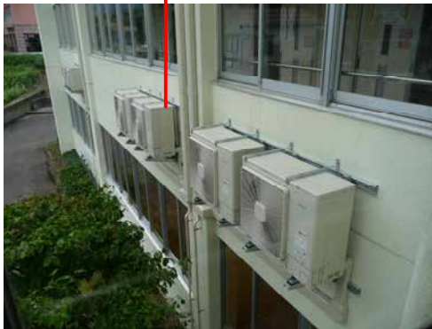
エアコン室外機
