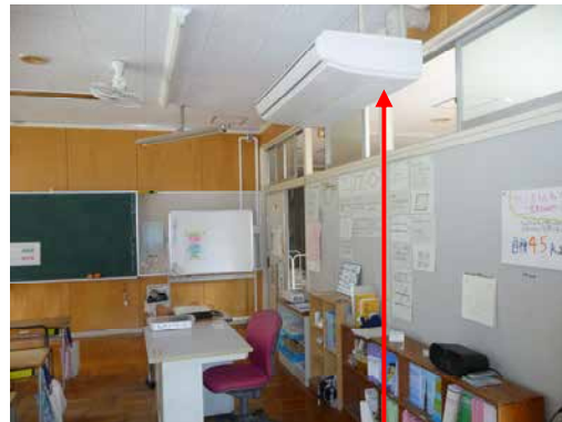
教室内エアコン(室内機)
