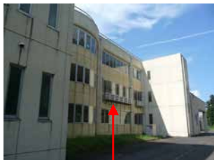
I 小学校 室外機
