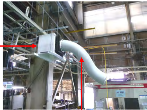
室内機からダクトで送風
