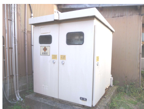
K 社 屋外キュービクル (不使用)
