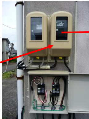
電力メーター
