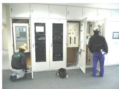
監視盤、制御盤
