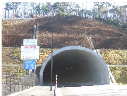
柏崎トンネル (LED照明)
