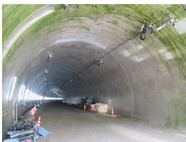
1 号トンネル照明設備
